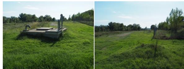
F18. Instal·lació ATLL. Abastament en alta F19. Vista direcció sud
