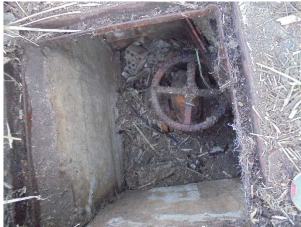
Vàlvula existent en la canonada d'aigua
