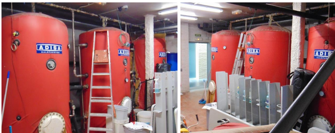
Dipòsits ACS existents de 2.000 litres.
