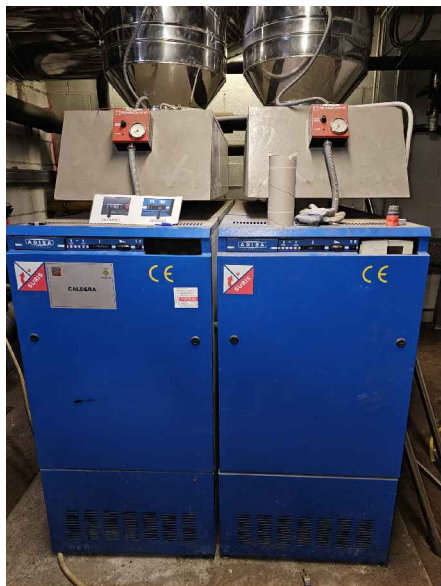
CALDERES ACTUALS (EQUIP A SUBSTITUIR)
